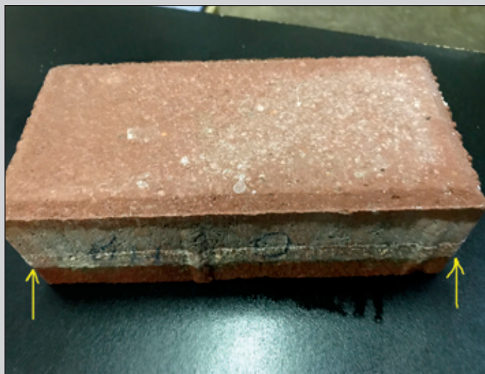
Фотография 9. Осаждение солей из раствора на боковой поверхности плитки, обработанной гидрофобизатором.
